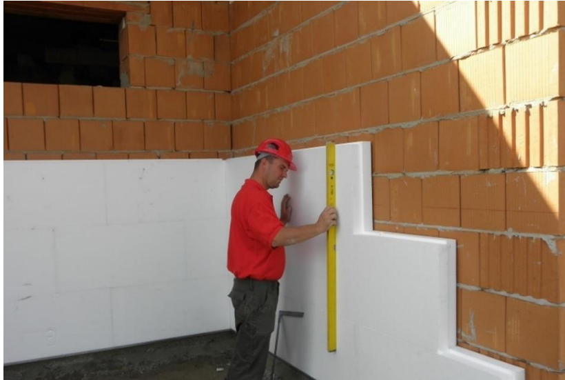
7. ábra Expandált polisztirolhab, azaz EPS, közbeszédben „hungarocell” hőszigetelés szerelése [ábra forrását lásd később]
